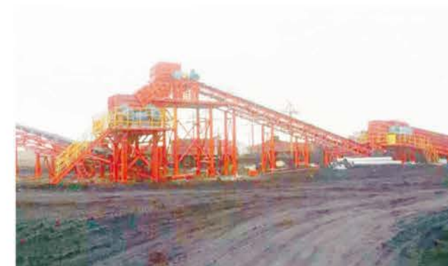
新疆特变电工1000t/h筛分破碎站
