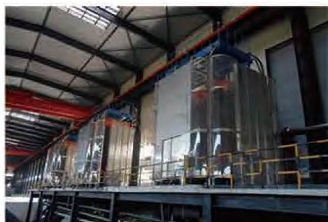
BLZG168m²立式压滤机使用现场 (氰化金尾渣)
